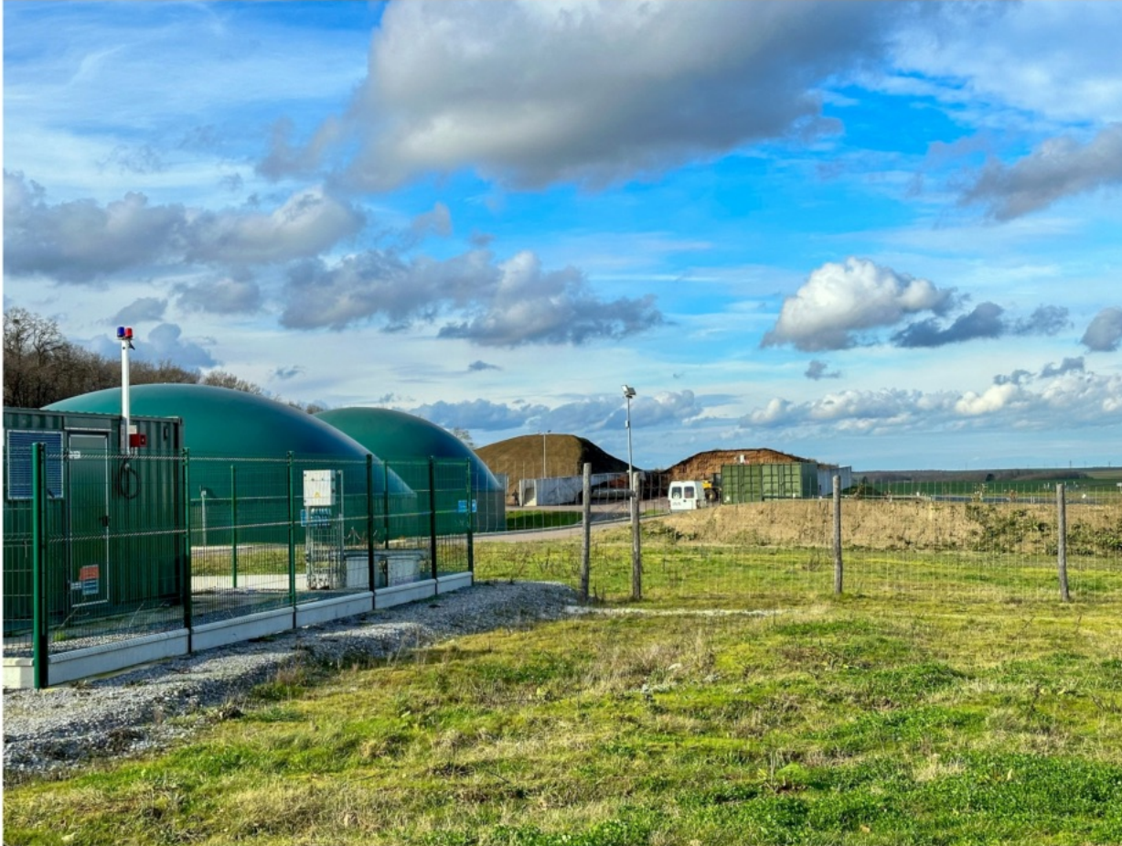
Usine de méthanisation
