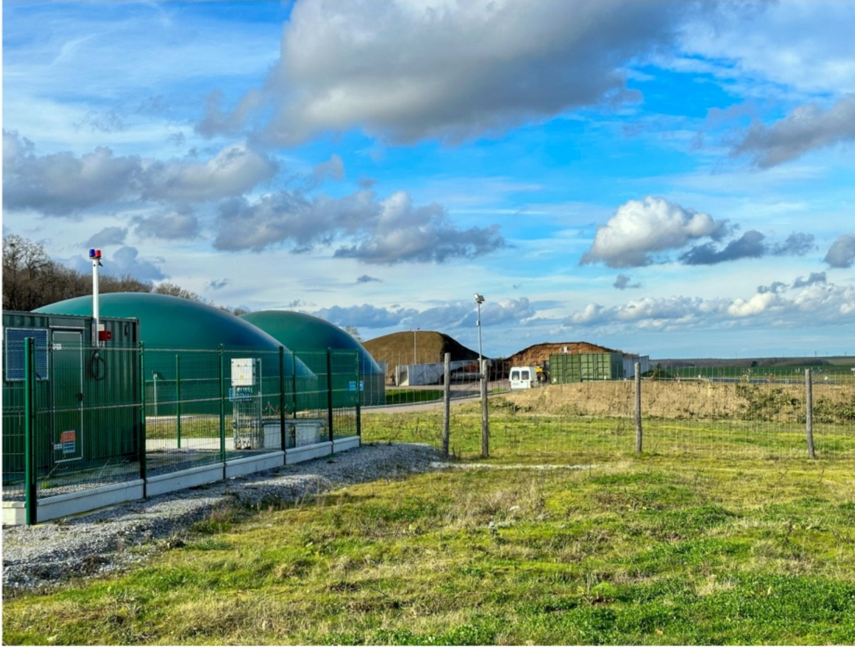
Usine de méthanisation
