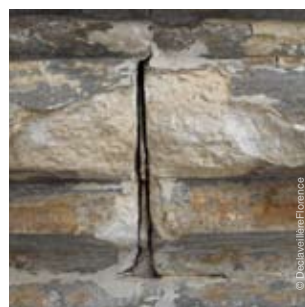
Détérioration par les silicates et peintures organiques
