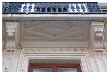
Détail des dessous de balcons en pierre à restaurer
