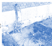
Apparition de végétation sauvage s'immiscant dans la dalle
