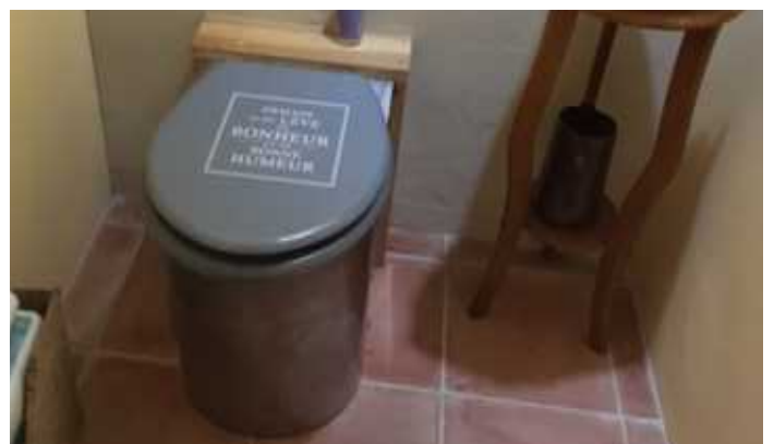
Toilette inox installée
