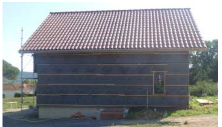
Vue sur l'accès au composteur sur la façade nord de la maison - en cours de construction
