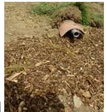
Vue sur un des filtres réalisés avec la chute d'eau
