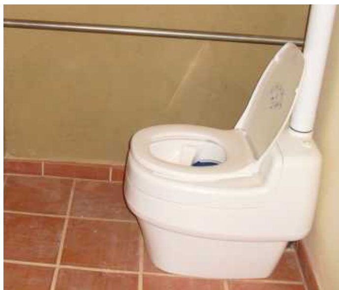
Toilettes installées avec tuyau de ventilation
