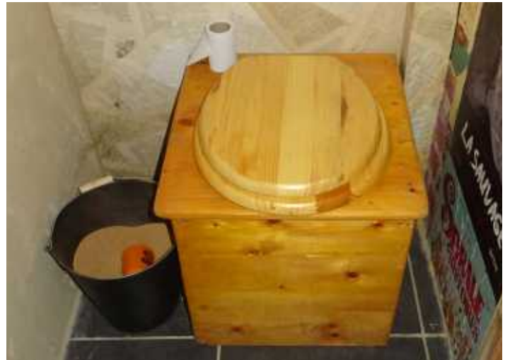
Photo de la toilette installée
