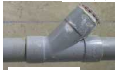
Y sur canalisation
