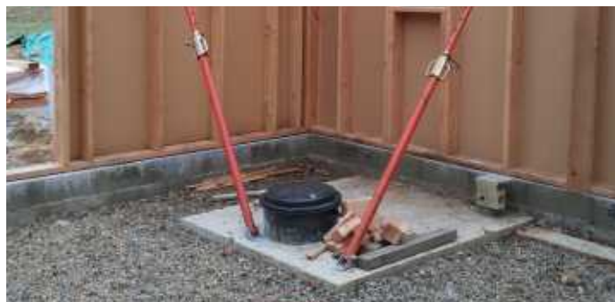
Réservation dans l'hourdis pour le passage de la colonne de chute réalisée avec une poubelle de 80 L
