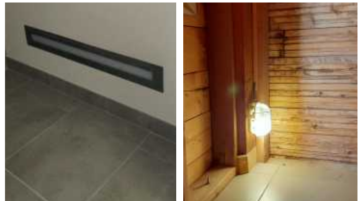
Eclairage encastré ou applique en partie basse de mur
