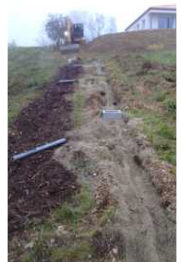
Vue depuis le bas du système avant recouvrement : les tuyaux arrivent au dessus des filtres remplis de broyat de bois
