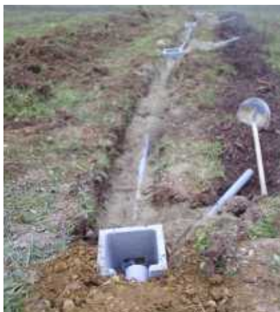
Vue du système depuis le premier regard répartiteur
