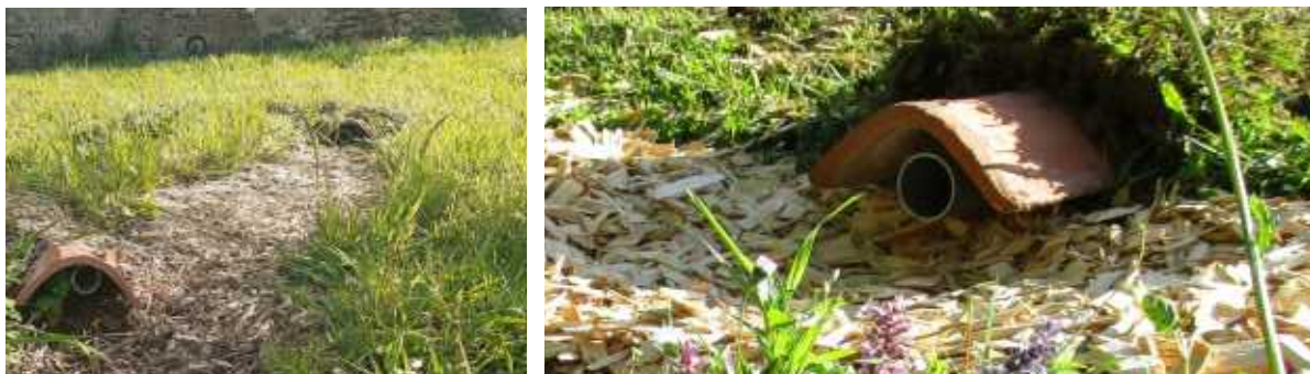
Figure 5 : Exemples d'arrivées de tuyaux au niveau des filtres
