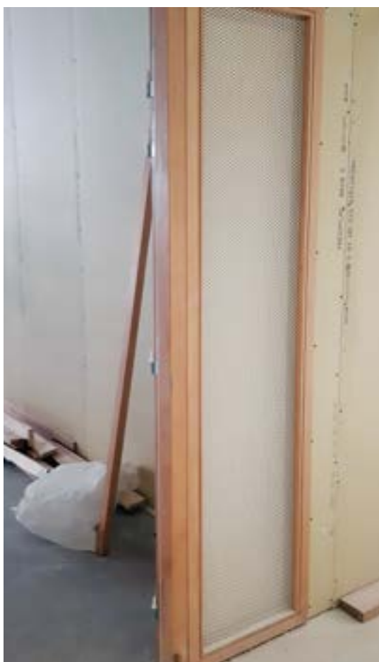
Grille de ventilation donnant sur le couloir à l'école de Lyon Confluence
