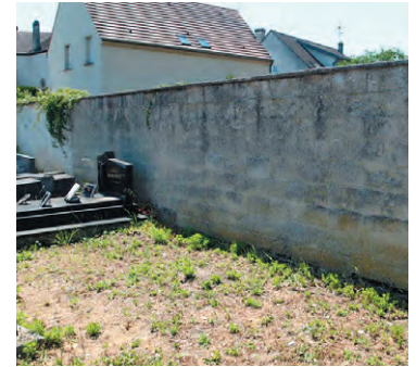
Mur en parpaing qui mériterait d'être végétalisé. Cimetière de Ver-sur-Launette (60).
