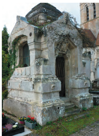
Chapelle monumentale affectée par l'abandon et qui mériterait une réfection dans le cimetière de Luzarches (95).
