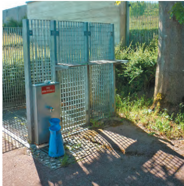
Aux Clayes-sous-bois (78), une borne fontaine est associée à chaque unité de tri des déchets. L'ensemble est en métal, avec avaloir sous caillébottis.
