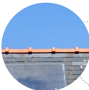
Faitage en tuiles canal
