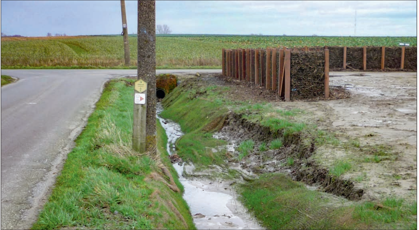
Afbeelding 8: Oevererosie, te wijten aan een onvoldoende door vegetatie bedekte perceelsrand en afwezigheid van een 1meter teeltvrije zone (foto: Inagro)
