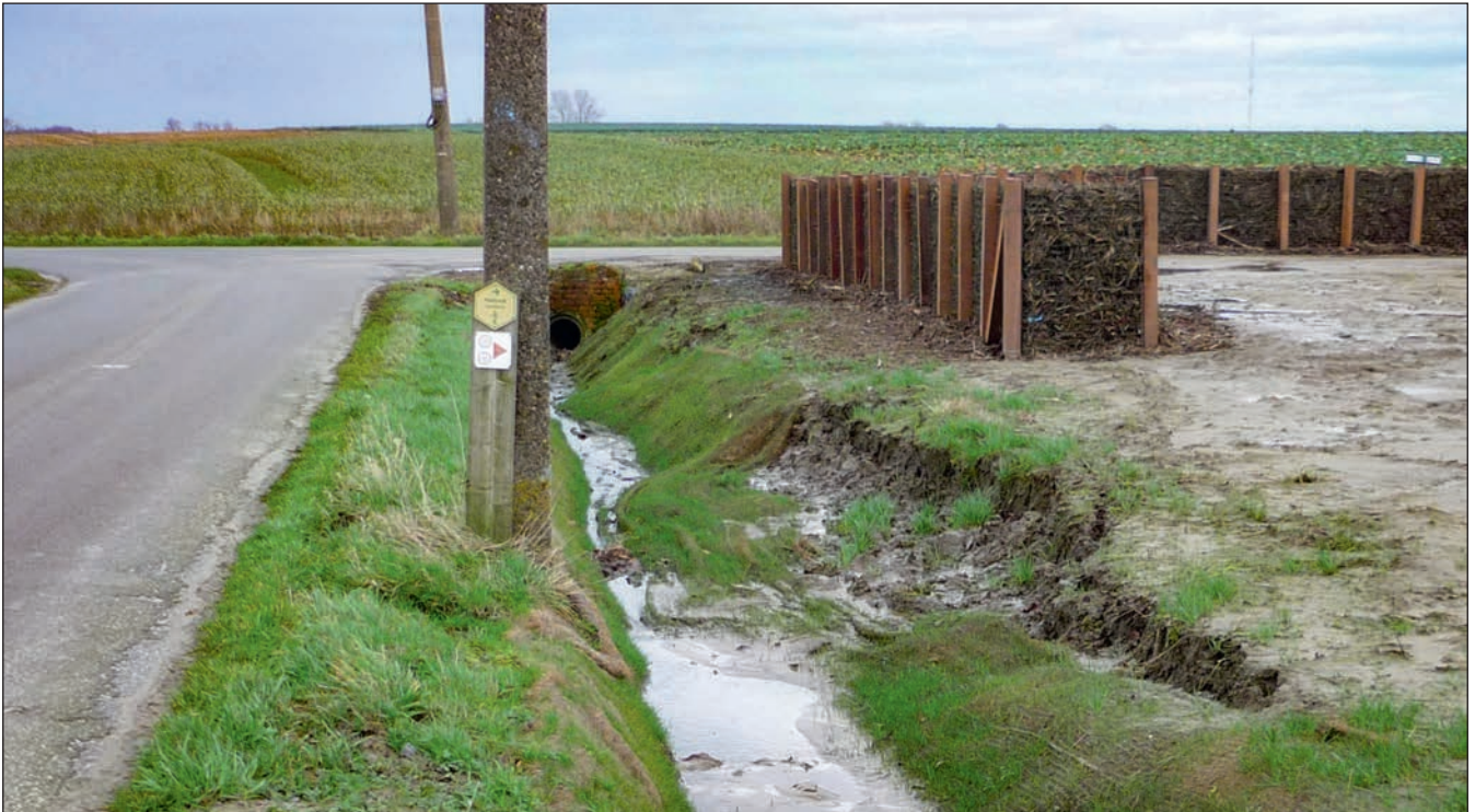
Figure 8: Erosion d'une berge à cause d'un talus pas suffisamment couvert de végétation et de l'absence d'une bande d'1 m non cultivée (Photo: Inagro)
