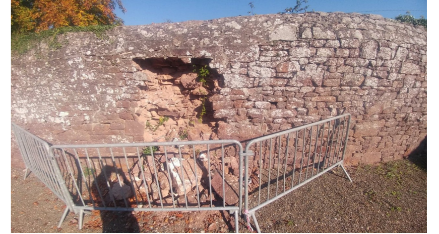
Érosion du mur d'enclos du cimetière
