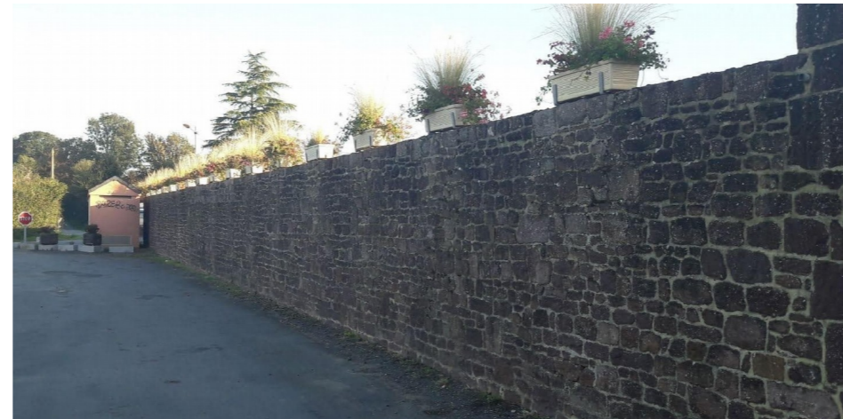
Pied de mur d'enclos du cimetière inesthétique
