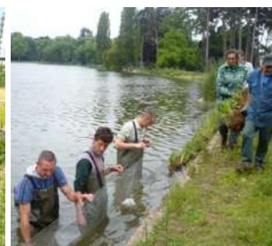
installation d'un boudin à hélophytes sur la berge étanche du Lac des Minimes, au Bois de Vincennes (12°)
