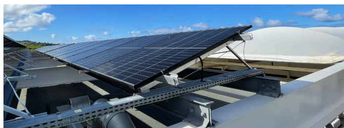
Vue des panneaux photovoltaïques en toiture
