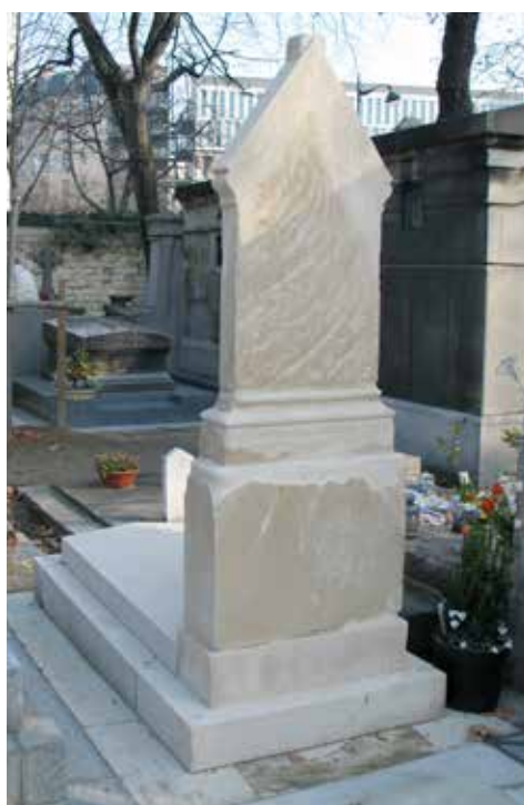
Sépulture dont la pierre est dégradée par nettoyage inadapté, à base de produits chlorés projetés à forte pression. Cimetière Montparnasse, Paris.
