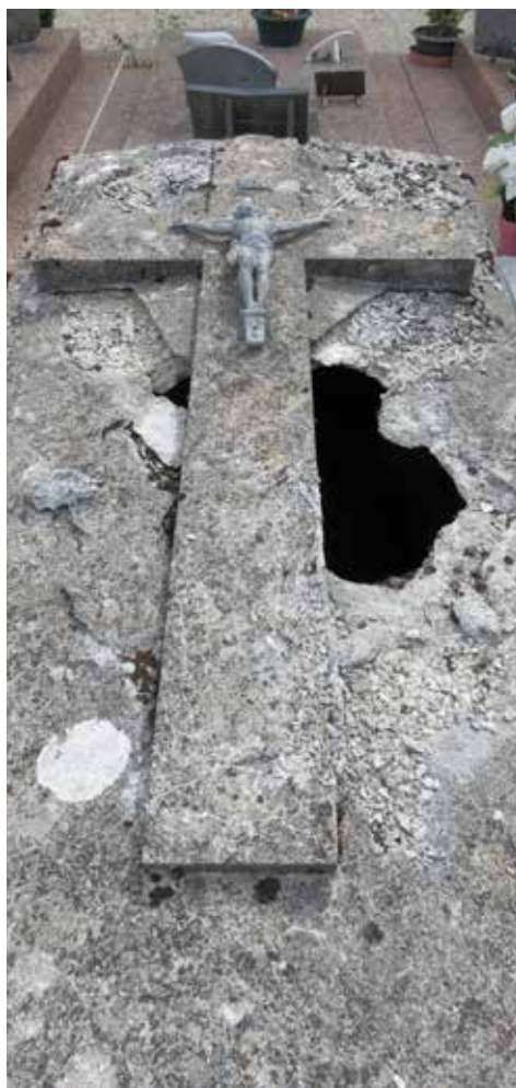
Tombeau en pierre reconstituée, cimetière de la ville basse, Provins (Seine-et-Marne). Une fabrication sans doute défectueuse en a accéléré le délitement.
