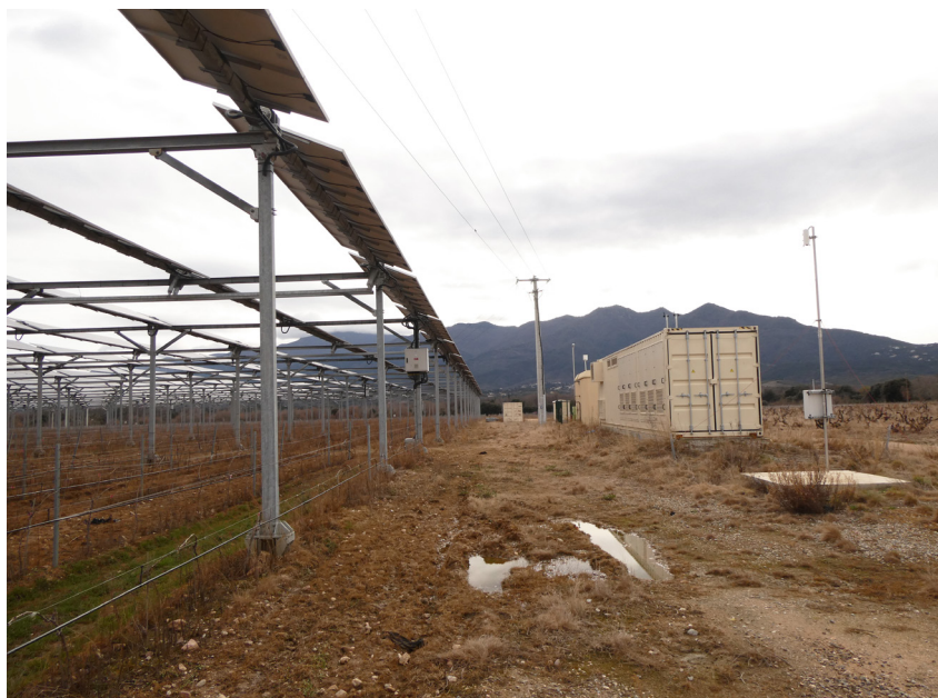
Le transformateur et les lignes électriques distribuant la production des panneaux
