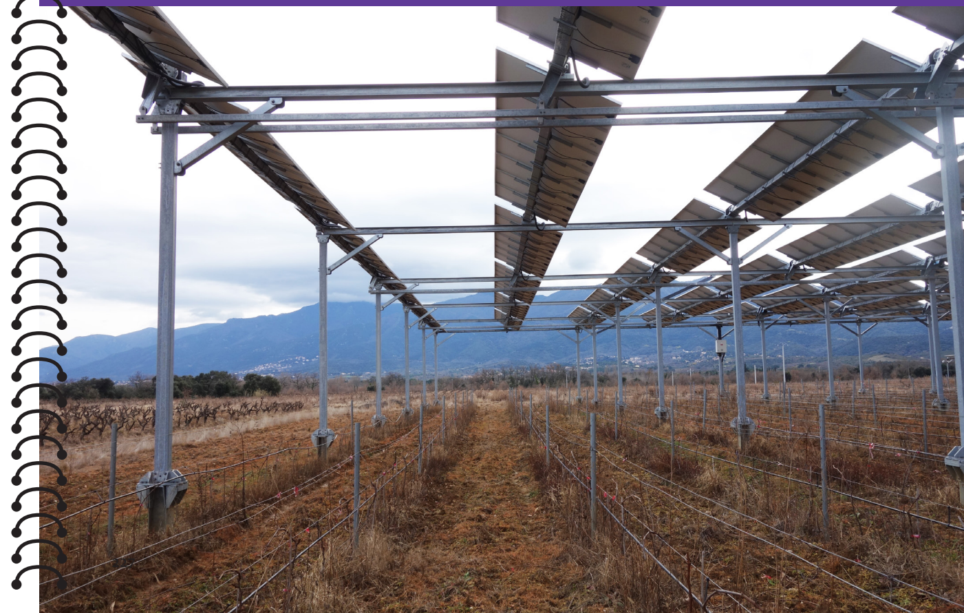
La parcelle en agrivoltaïsme du domaine de Nidolères, une structure métallique imposante
