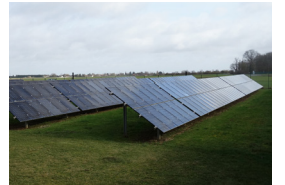
Panneaux photovoltaïques au sol devant les locaux de la régie
