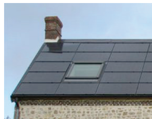
Panneaux solaires parfaitement intégrés, qui soulignent la silhouette des villages
