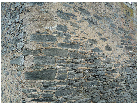
Enduit ancien dégradé par le temps et laissant voir les moellons de schiste.
