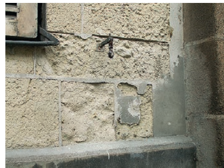
Dégradation d'un mur : l'humidité ressort au-dessus d'un soubassement cimenté.
