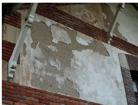
Vestiges d'un badigeon de chaux sur une villa du XIX e siècle.
