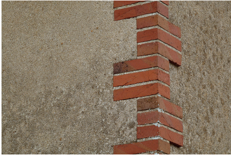
Enduit ancien légèrement en retrait du « nu » de l'encadrement en briques.
