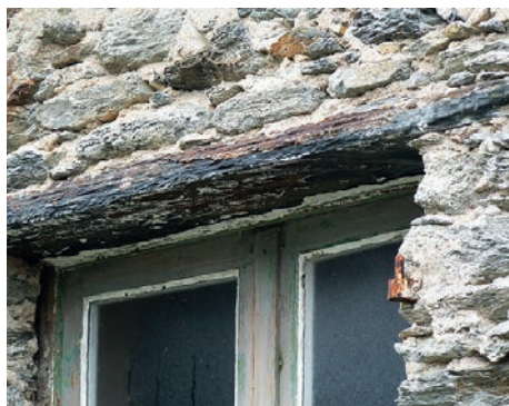
Maison rurale, à linteau en schiste, dont les murs en moellons devraient être réenduits.
