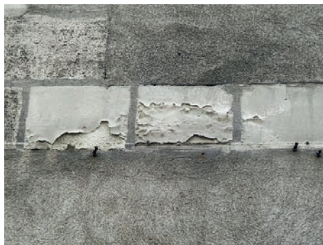
Après la pose d'un enduit au ciment, l'humidité dégrade les pierres du mur.
