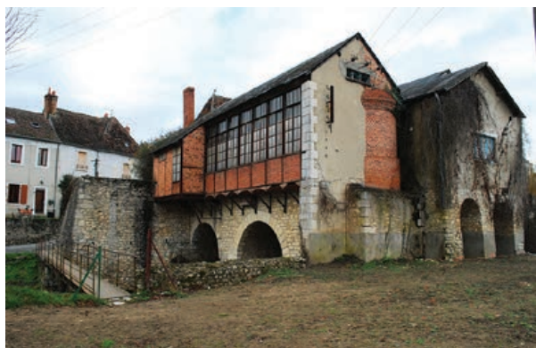
Parc de la Brenne : Point de vue 098. Menaces de mort sur bâtiments historiques (2011).
