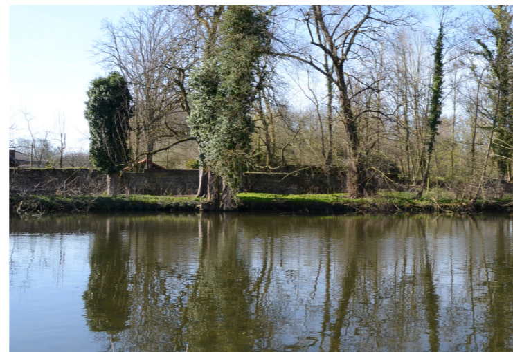
Berge sud abîmée
