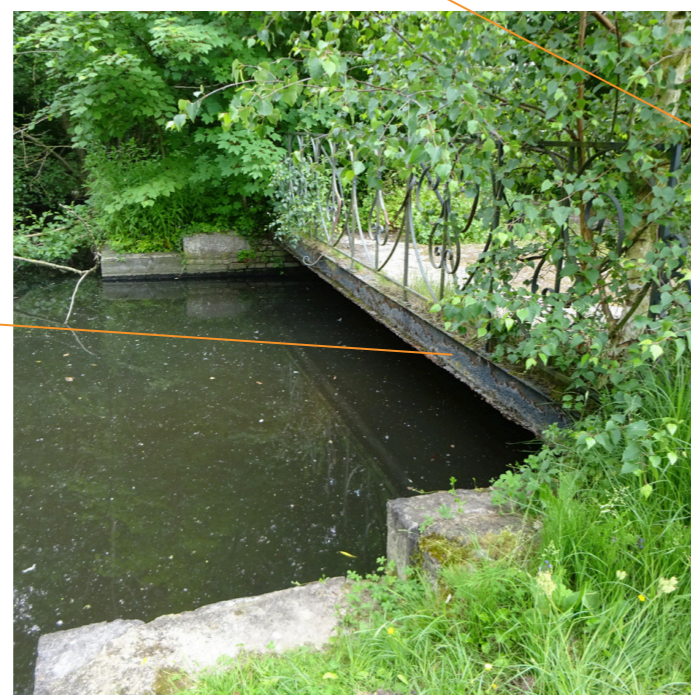
Pont en poutre métallique et tablier en béton : système à repenser
