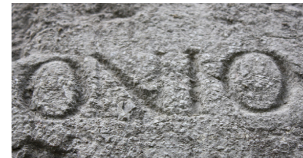
Les lettres sont usées
