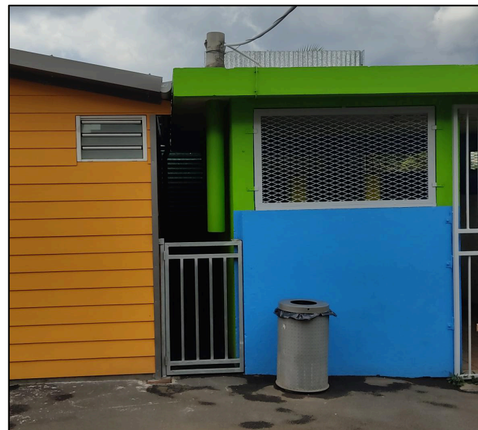
Failles entre bâtis sécurisées mais non valorisantes
