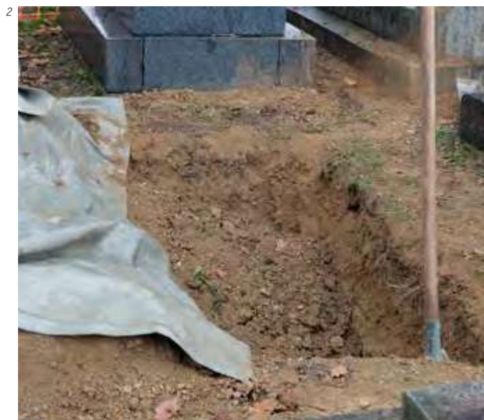
2 - Creusement en cours d'une fosse pleine terre par les agents municipaux fossoyeurs dans le cimetière de l'Est de Rennes (35). Ici, les fosses en pleine terre peuvent y atteindre la profondeur de 2,50 m (trois cercueils superposés). © P&C - Sandrine LARRAMENDY 2015
