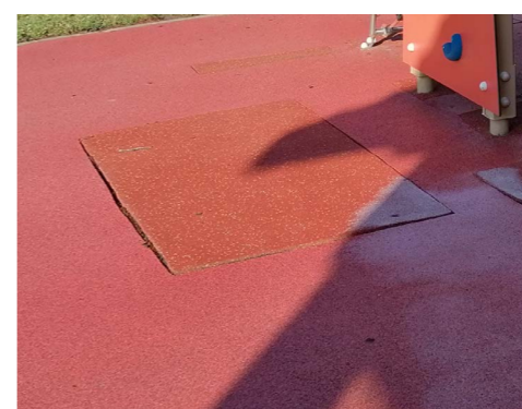
Sol souple non drainant dégradé
