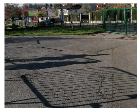
Sol enrobé non drainant dégradé
