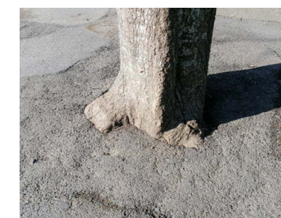
Mauvaise gestion du collet de l'arbre
