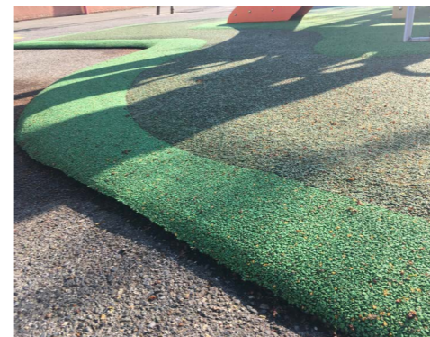
Jonction entre les revêtements de sol endommagée
