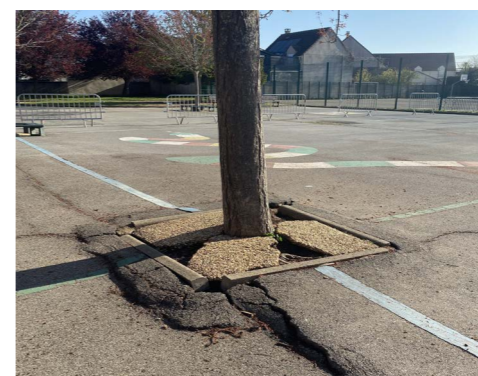
Jonction entre les revêtements de sol endommagés
