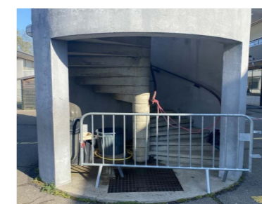
Accès à la coursive de l'étage condamnée
