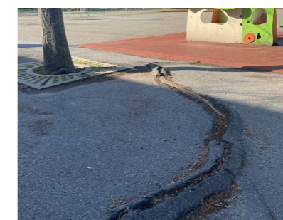
Problème dû à l'extension racinaire
