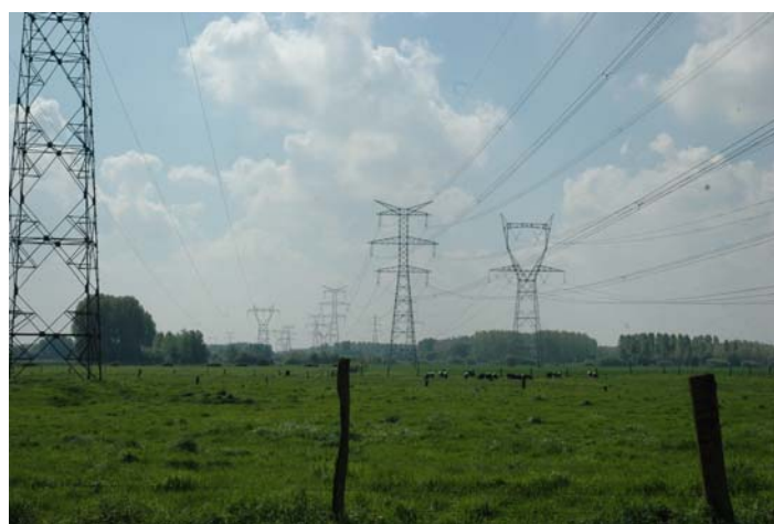
Couloir de lignes électriques Nord-Sud sur tout l'EPMR
