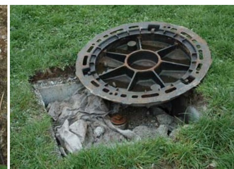
Puits « N°3 » vandalisé
