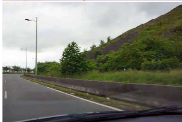
Glissière en béton armé bordant la D262 et ceinturant le pied du terril 97 à Méricourt
