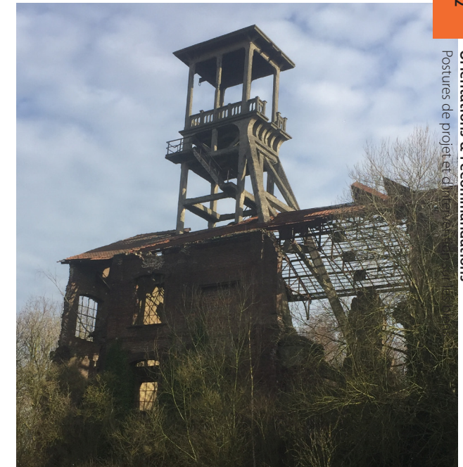
Anhiers, fosse n°2 de Flines / ancienne fosse avec chevalement en béton, propriété privée en très mauvais état. Absence de projet, et cumul de difficulté dont servitudes de risques importantes.
