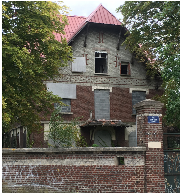
Loos-en-Gohelle, maison d'ingénieur de la Cité des Provinces Maison abandonnée, dégradée fortement par un incendie sans projet
