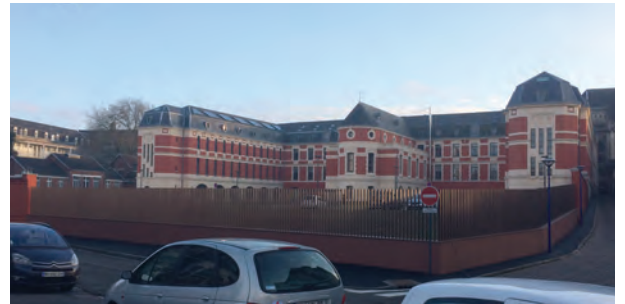
Préconisations d'intervention sur le mur de clôture de l'Hospice Saint-Pierre et son jardin, donnant sur l'espace public de la rue du Crinchon.
