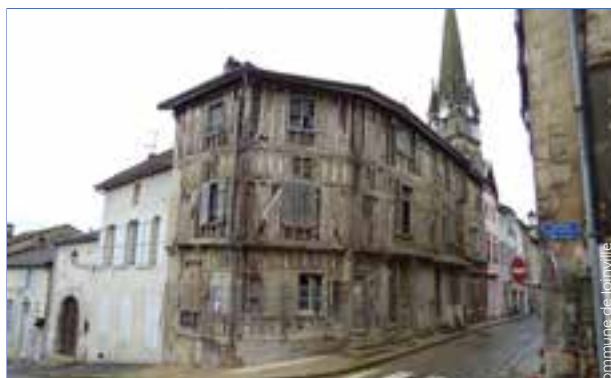
Habitat dégradé faisant l'objet d'une ORI
