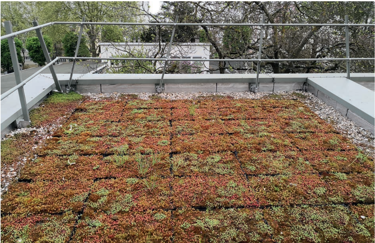
Les toitures végétalisées sont souvent proposées sous la forme de végétaux conditionnés en site de production. Une analyse de cycle de vie (ACV) pourrait s'avérer nécessaire pour évaluer leur impact global. © Marc Barra | ARB idF
