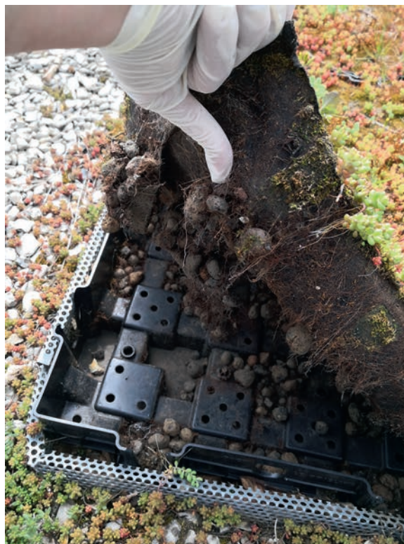
Certains systèmes de végétalisation se dégradent et peuvent laisser des traces. S'affranchir du plastique est plus que jamais essentiel dans la conception des toitures végétalisées © Marc Barra | ARB îdF
