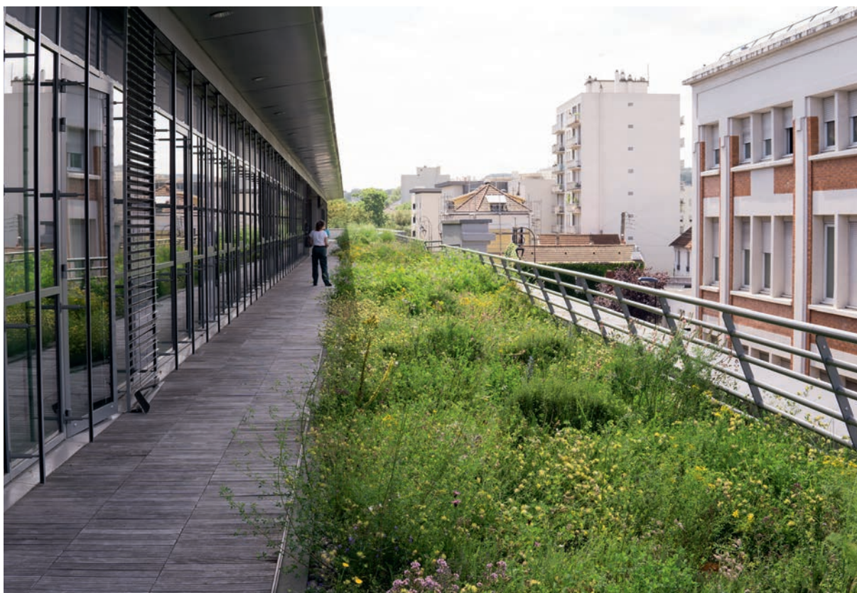
Toiture végétalisée réalisée par Topager sur le siège de GTM Bâtiment à Nanterre © Audrey Muratet | ARB idF
