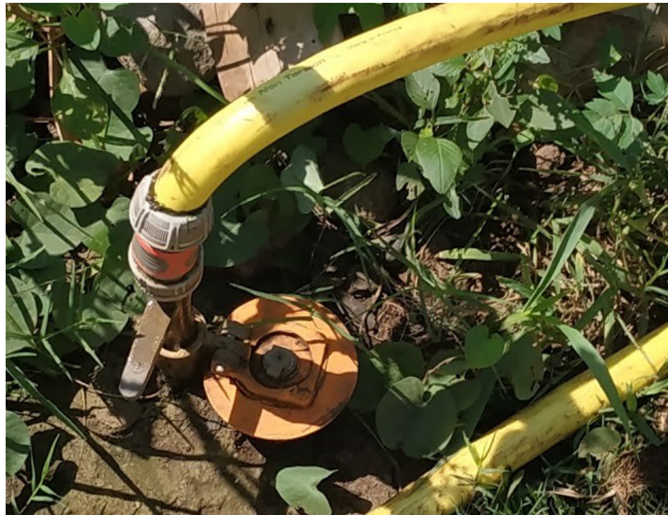
Tuyau d'arrosage clipsé à la vanne dans le Jardin d'Anchaing
