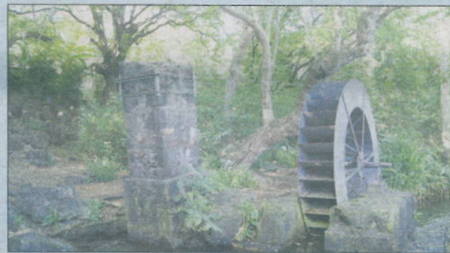
La colonne, à côté du Moulin à eau, menace de s'effondrer.
