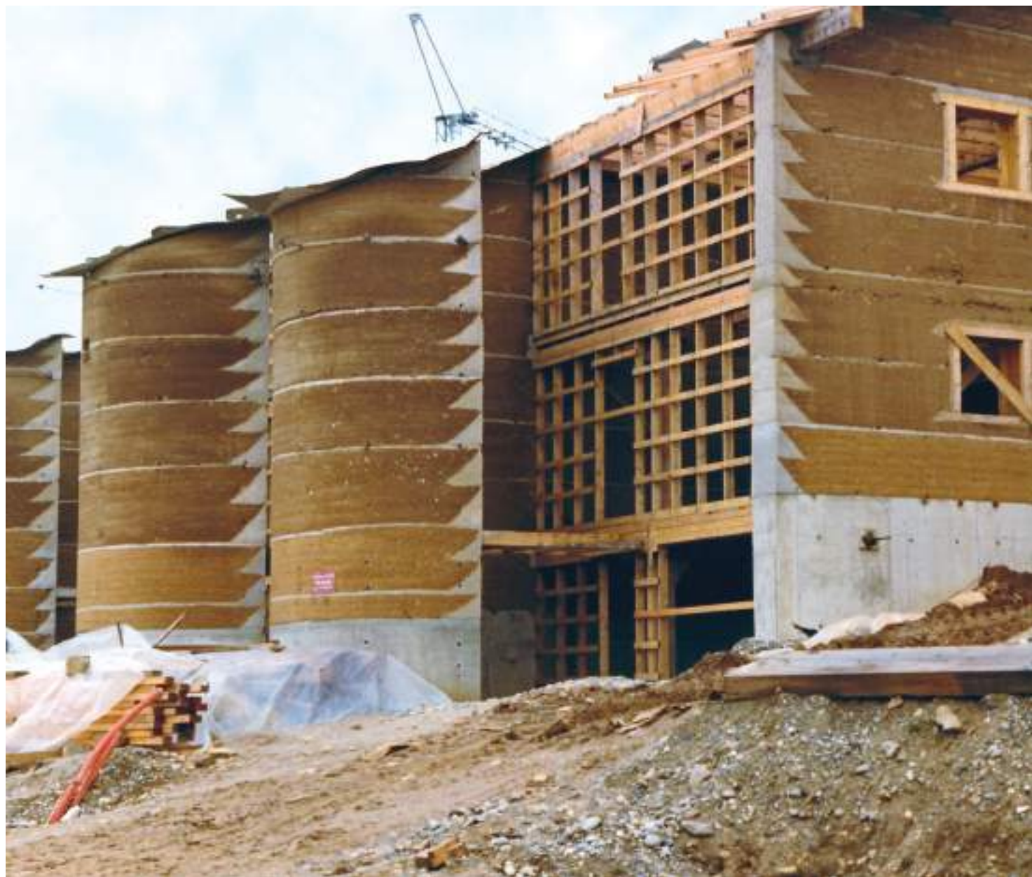
Îlot B : une double ossature bois et du pisé associé au béton sont mis en œuvre en façade nord.
