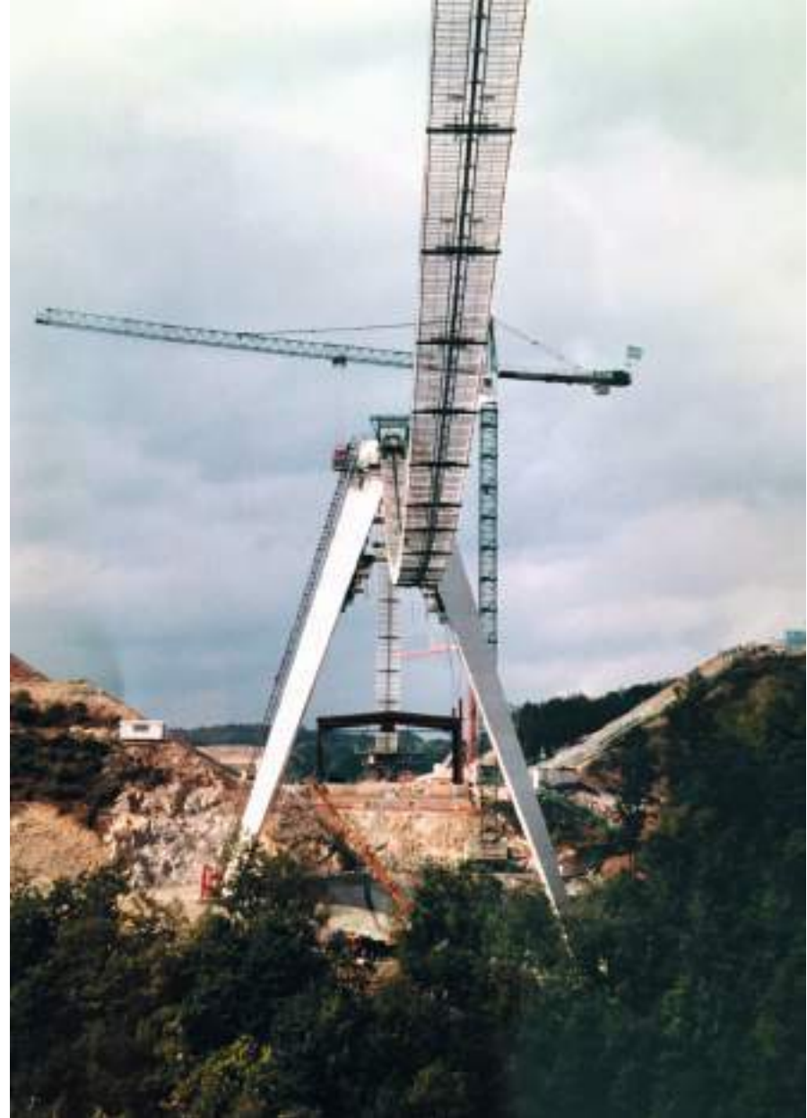
Construction des pylônes en partie supérieure de la gorge et lancement des câbles porteurs.
