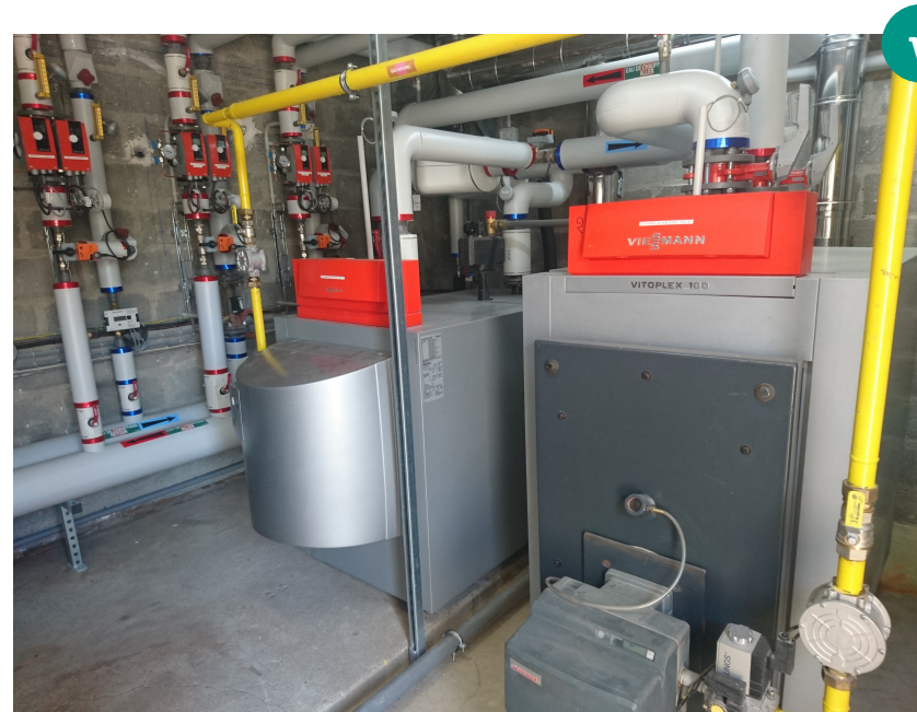
Chaudière réemployée à droite en appoint d'une chaudière principale (à gauche) plus performante.
