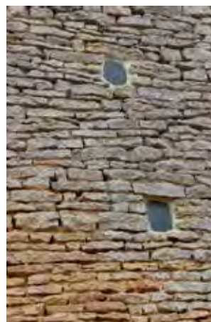
TROUS DE BOULINS OBSTRUÉS PAR LA POSE D'UNE ARDOISE
