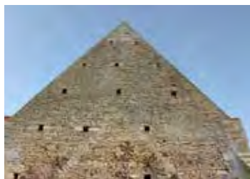
TROUS DE BOULINS SUR LA FAÇADE
