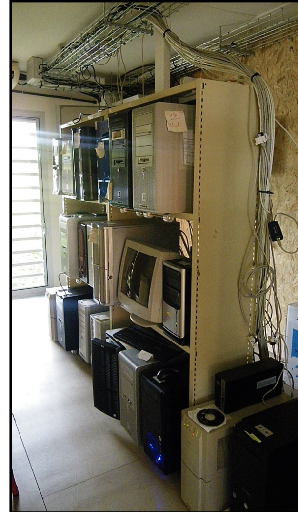
Unités centrales : regroupées dans local informatique sécurisé et climatisé
