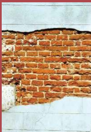
Désagrégation des briques due à l'arrachage d'un enduit
