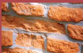
Détérioration des briques par un sablage non contrôlé
