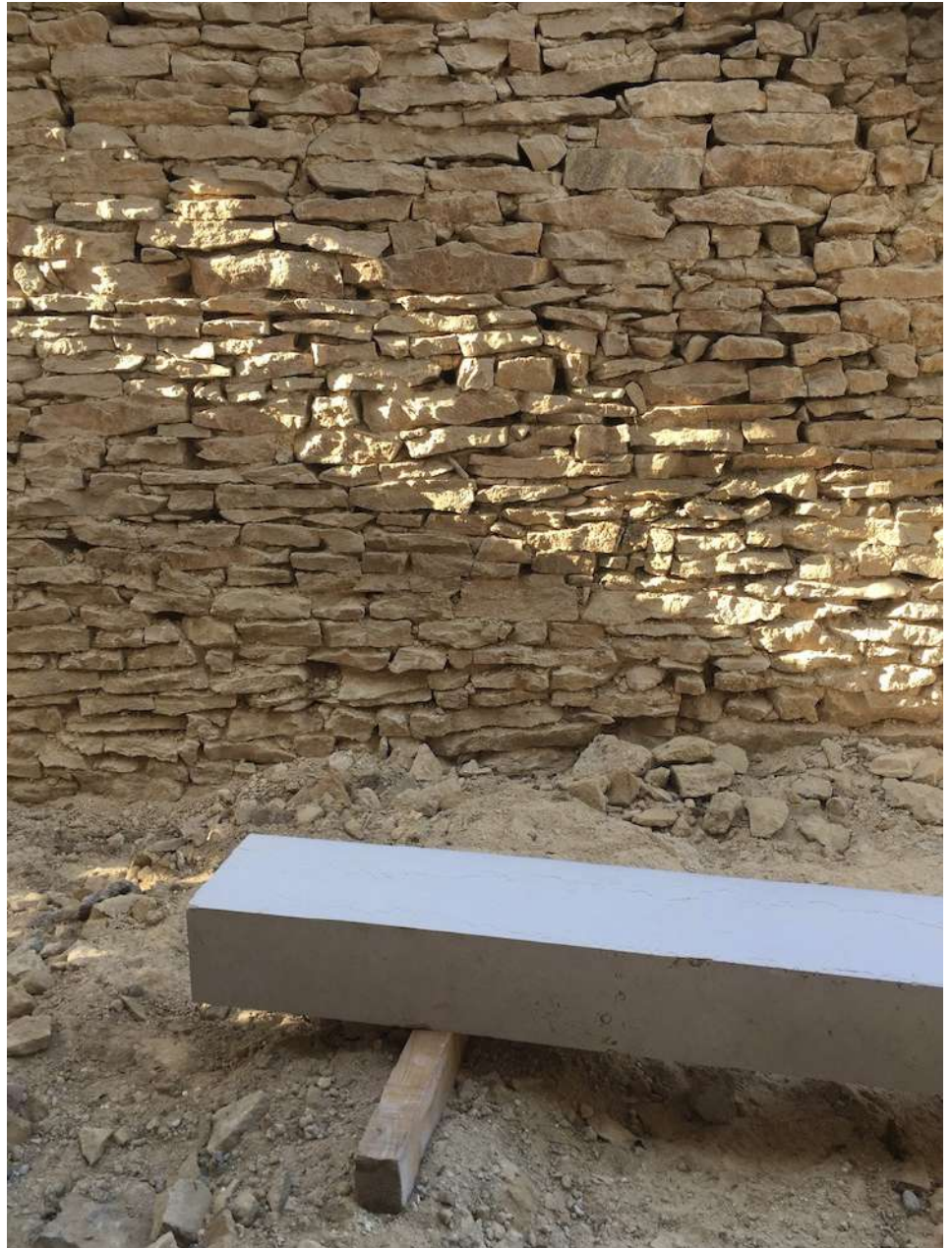
Le linteau de la porte d'entrée avant la pose. Pierre de Villebois - Carrière du Bugey
