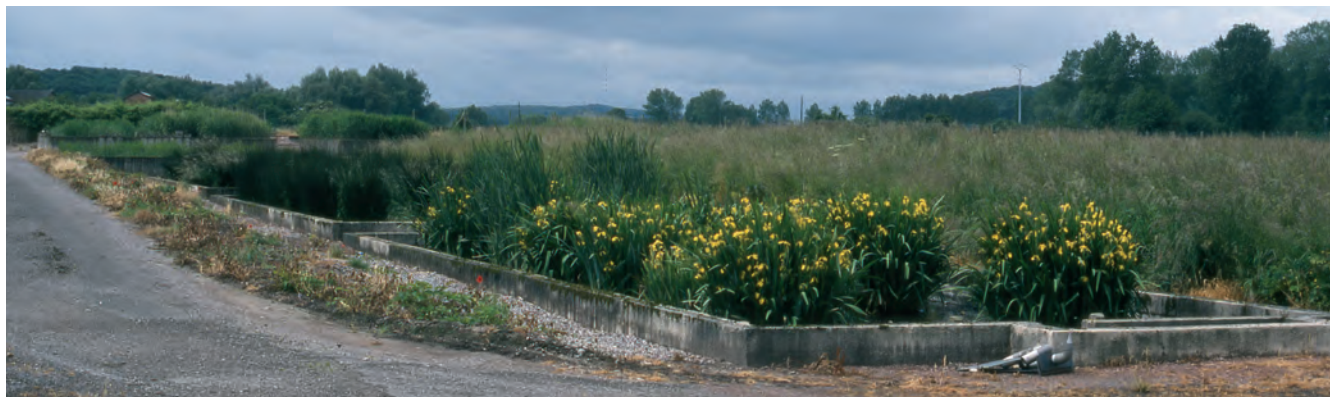
Station de traitement des eaux usées par lits à macrophytes de Pont-Remy (Basse Somme)
