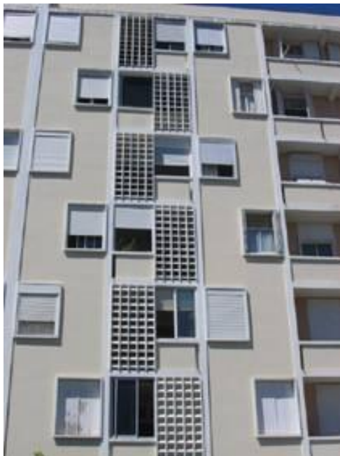
Façade Nord de la Résidence : les varangues encastrées sont empilées et protégées par moitié par une structure en « boîte à œufs ». On peut noter les survitrages coulissants ajoutés par les résidents, qui réduisent les débits de ventilation.
