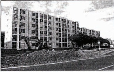
Deux opérations pilotes de réhabilitation ont été présentées hier à Saint-Denis, dans les quartiers Vauban et Camélias.
