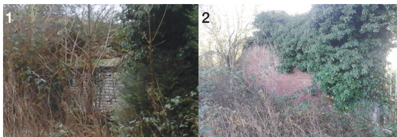
1,2-Masqué en grande partie par une végétation invasive, le mur d'enceinte encore existant doit être révéler. Cette part entière du domaine sera restaurée par les acquéreurs.
