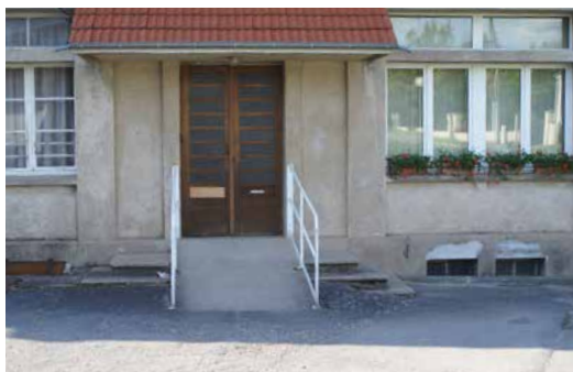
Accès non praticable et en pente vers la mairie – AVANT
