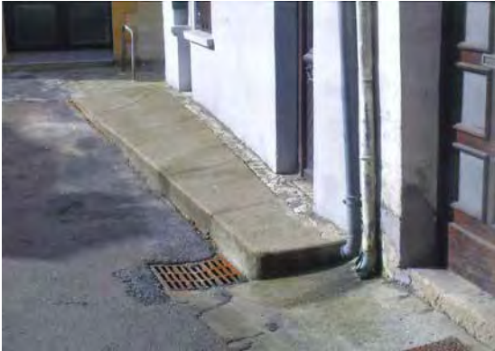
Trottoir étroit et irrégulier, - AVANT présence d'un seuil entre le bâtiment et la rue
