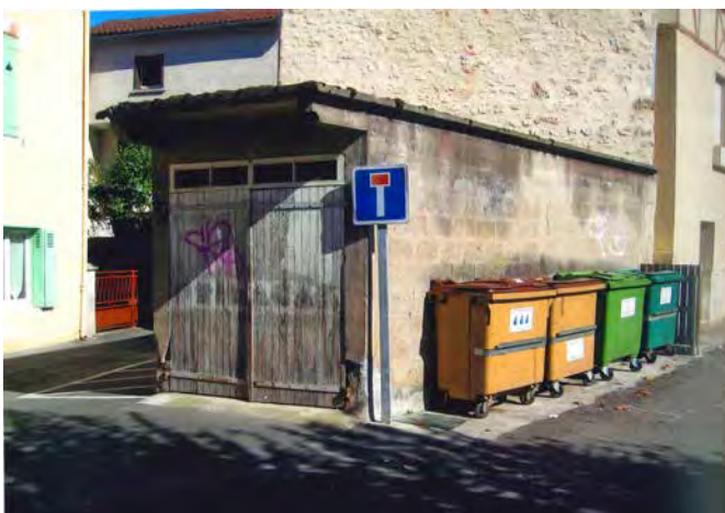
Bâtiment technique dégradé et containers – AVANT très visibles depuis la place du Figuier
