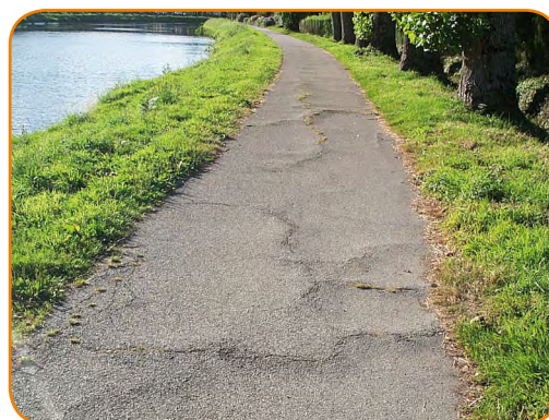
Remontées racinaires sur le revêtement en enrobé de Canal de Nantes à Brest
