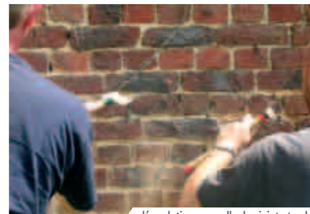
dégradation manuelle des joints tendres
