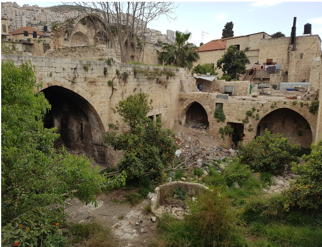
Fig.36 Le Palais Tuqan, vestige de l'époque ottomane aujourd'hui en état de dégradation avancée. Des travaux sont actuellement en cours pour tenter, petit à petit, de le rénover. Source : Atelier Lille-Naplouse 2017
