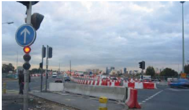
Le pont de Bezons est un point de confluences de nombreux transits. La très grande fréquentation de transit de ces espaces leur a fait perdre leur dimension locale. Le vocabulaire exclusivement routier ne permet pas de mettre en valeur cette situation grandiose et stratégique dans la structure urbaine dans un axe remarquable vers La Défense.
