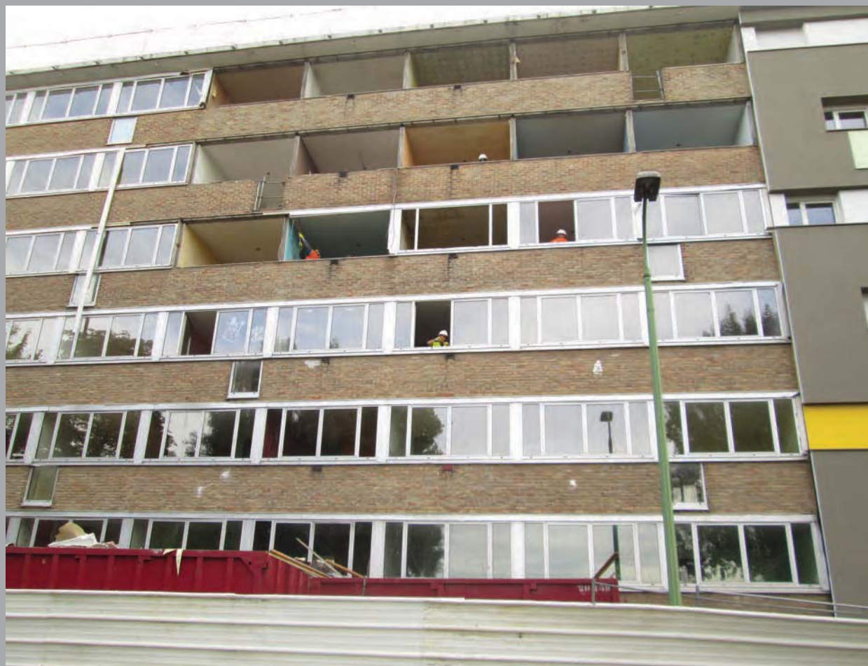
Troisième tranche travaux : dépose des menuiseries de la façade sur rue J.B Corot
