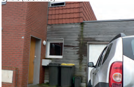
Mauvaise gestion d'écoulement des eaux pluviales entre un habillage tuile et un mur bois en RDC - Pecquencourt
