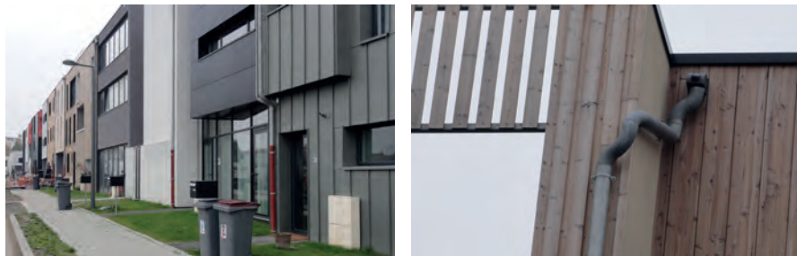
Maisons en bande sans traitement de l'intimité entre espace public et espace privé, les descentes d'eau pluviale n'ont pas été réfléchies et disqualifient l'image générale des façades - Quartier de Lille Sud
