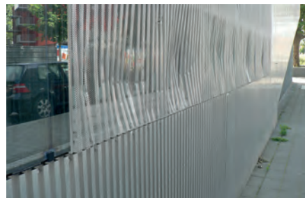
Dentelle de métal très fragile installée au contact de l'espace public et rapidement dégradée - Lille Sud
