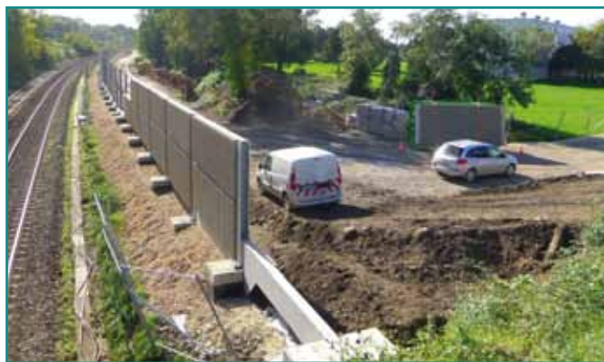
Exemple d'écrans acoustiques (Source SNCF Réseau)
