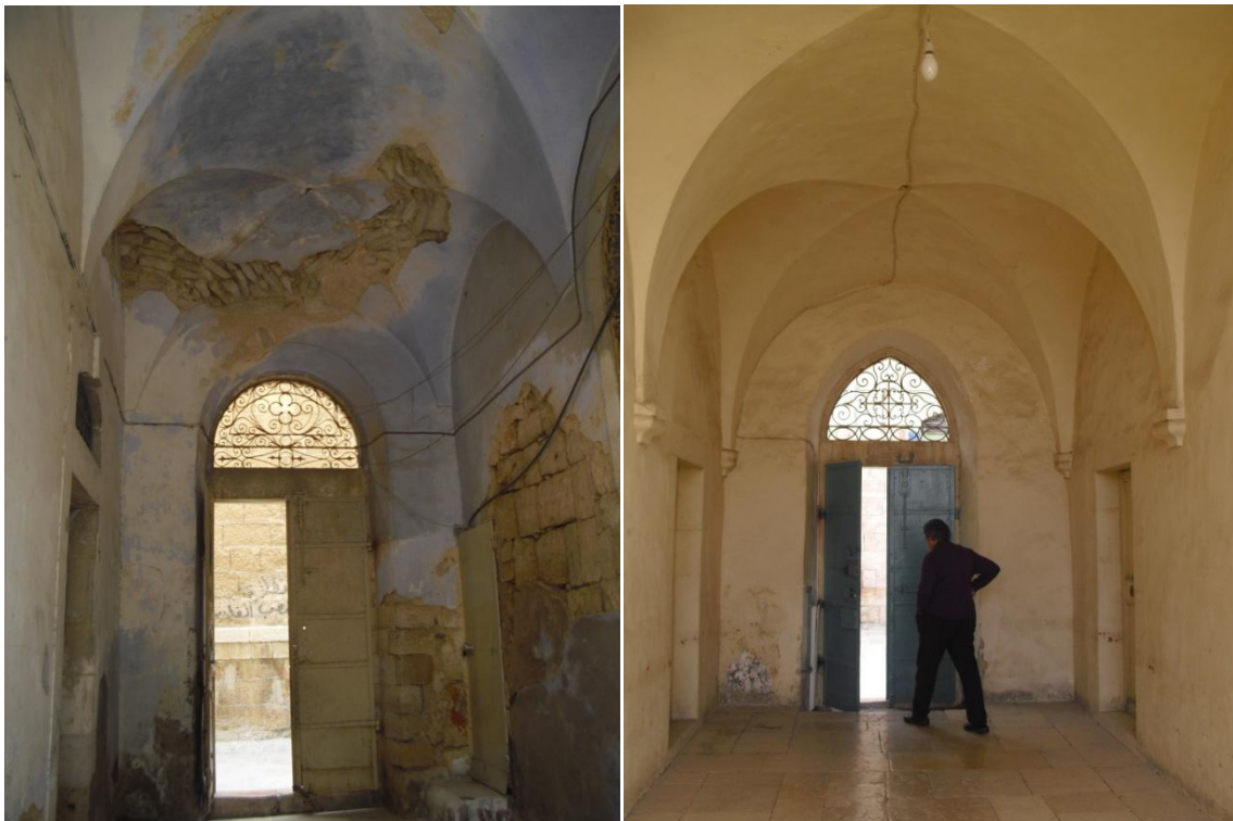
Figure 51 : Hall d'entrée couvert de voûtes d'arrêtes dans deux maisons de la vieille ville de Bethléem
